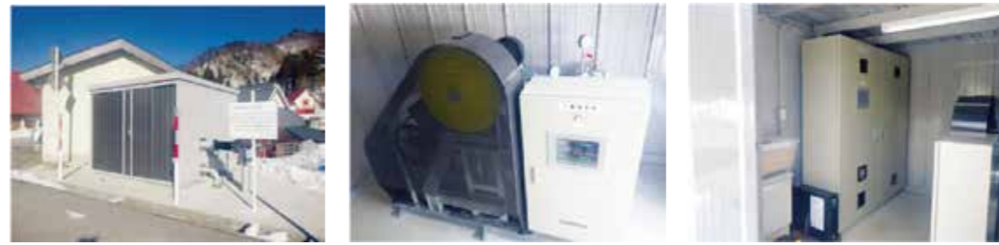
3m×3mの物置内に発電制御盤を含む水車設備一式を収納してパッケージ化を図っています。
